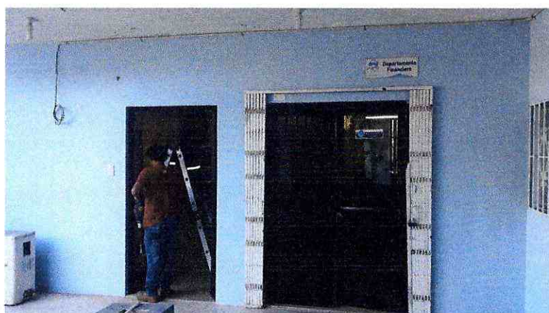
TRABAJOS DE ENLUCIDO DE BOQUETE DE PUERTA PRINCIPAL CON SU INSTALACIÓN DE PUERTA PRINCIPAL DE ALUMINIO Y VIDRIO, CORTE E INSTALACIÓN DE PUNTOS DE INTERRUPTORES (INCLUYE RESANE) Y MONTAJE DE PUERTA METÁLICA Y ACORDEON EN DPTO. FINANCIERO
