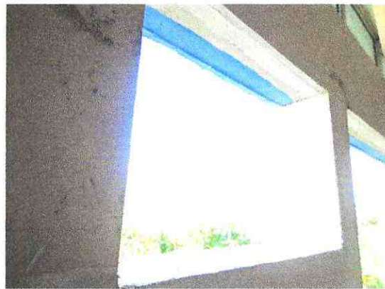
TRABAJOS DE MAMPOSTERÍA, ENLUCIO VERTICAL Y FILOS DE BOQUETES DE VENTANAS EN OFICINA DE CONTROL DE BIENES
